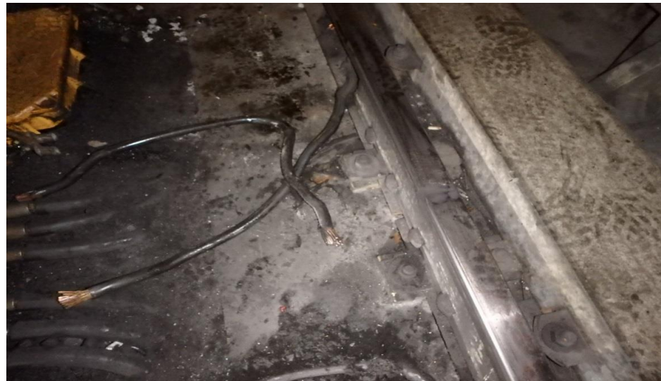
Câble de bobines inductives sectionné
